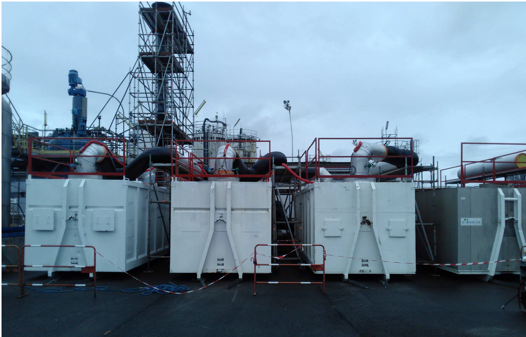
Caissons charbon actif
